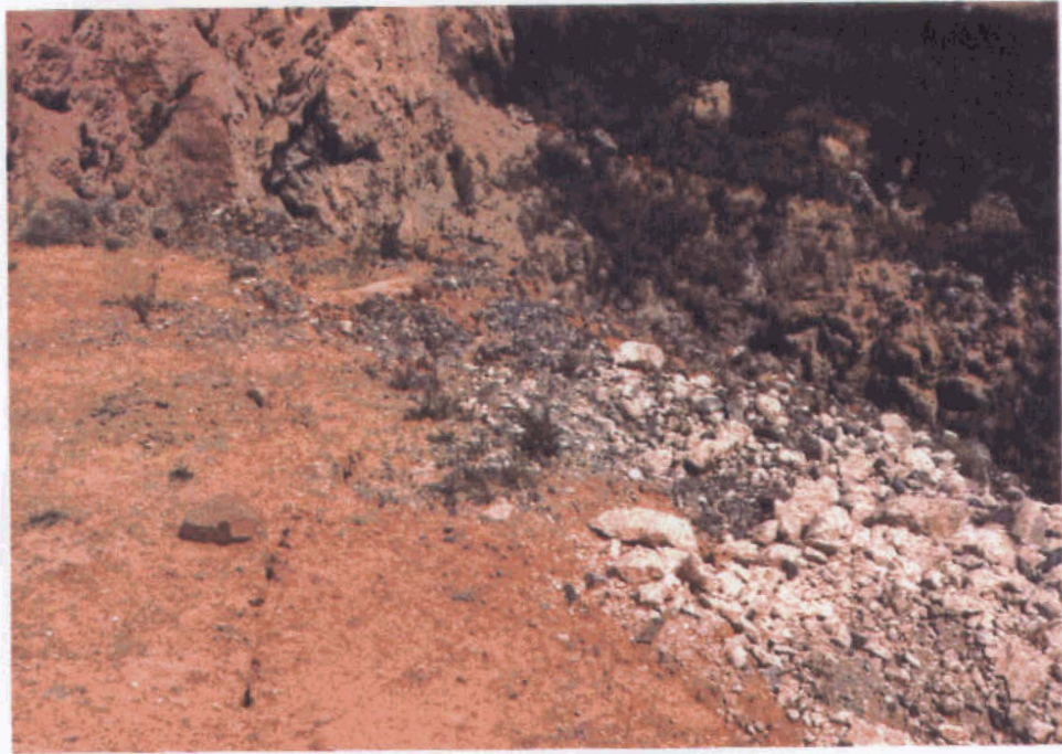
FOTO Nº 8.- DEFINICION DE GRIETAS EN UNA ESCOMBRERA DE ESTERILES DE COBERTERA
